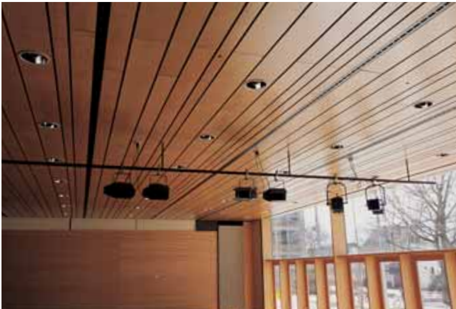
Gymnasium Metzingen Deckenverkleidung Can. Ahorn, B1
